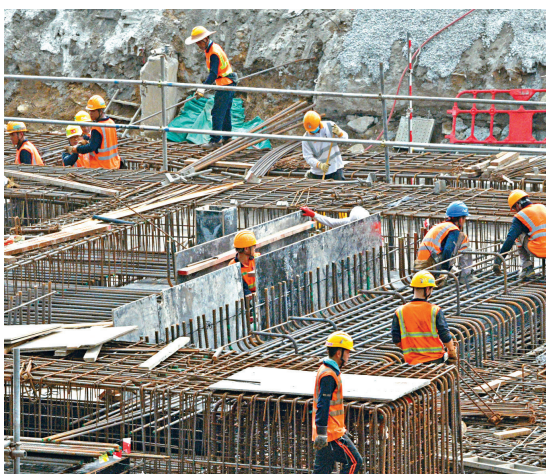
■內地限電連供應本港建築材料亦受影響。資料圖片
